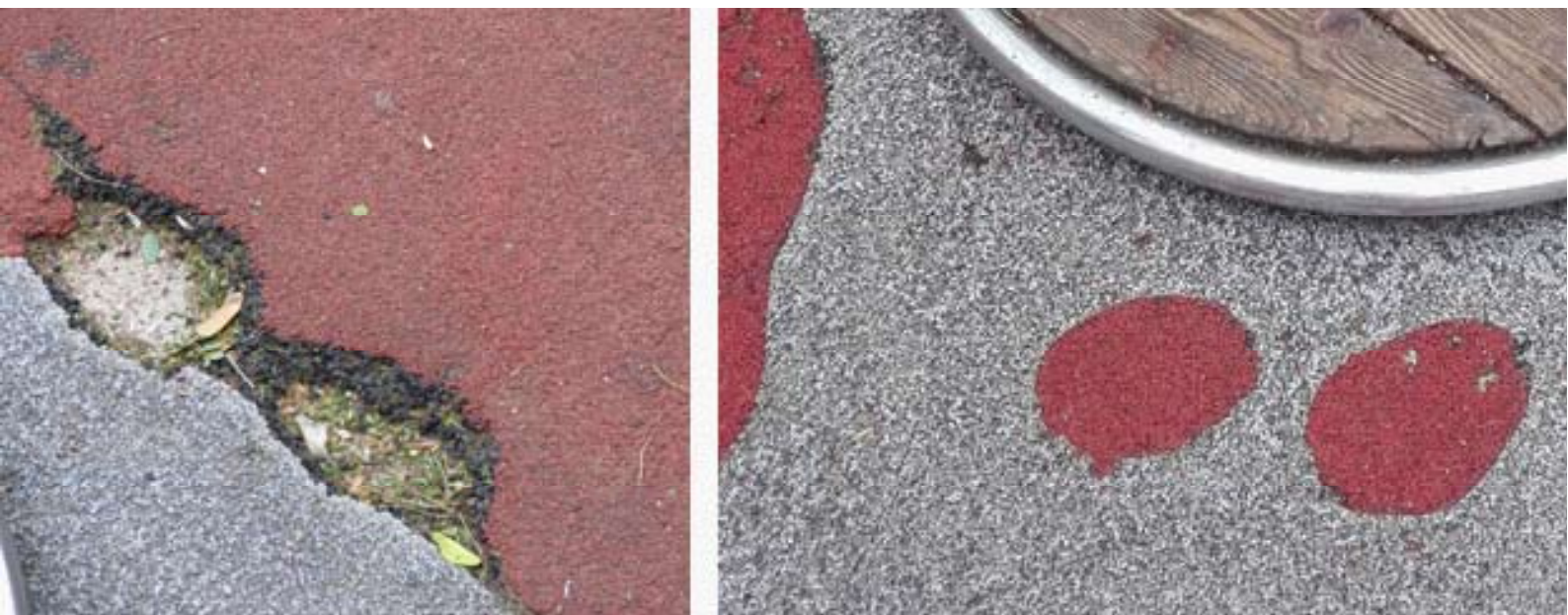
Figura 3: Izquierda: Grieta por desgaste del suelo, Derecha: Área agrietada reparada
