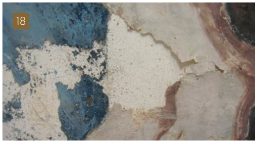
[18] Aixecament acusat de la pel·lícula pictòrica en perill de despreniment (Fotografia: Viviana López).
