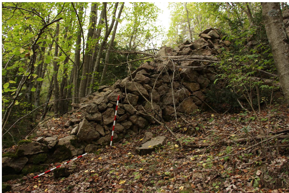
Figura 9. Estat actual de l'escalinata d'accés a la Torre Moreta (identificable a la cantonada esquerra de la fotografia anterior donant accés a l'edifici principal). Font: elaboració pròpia
