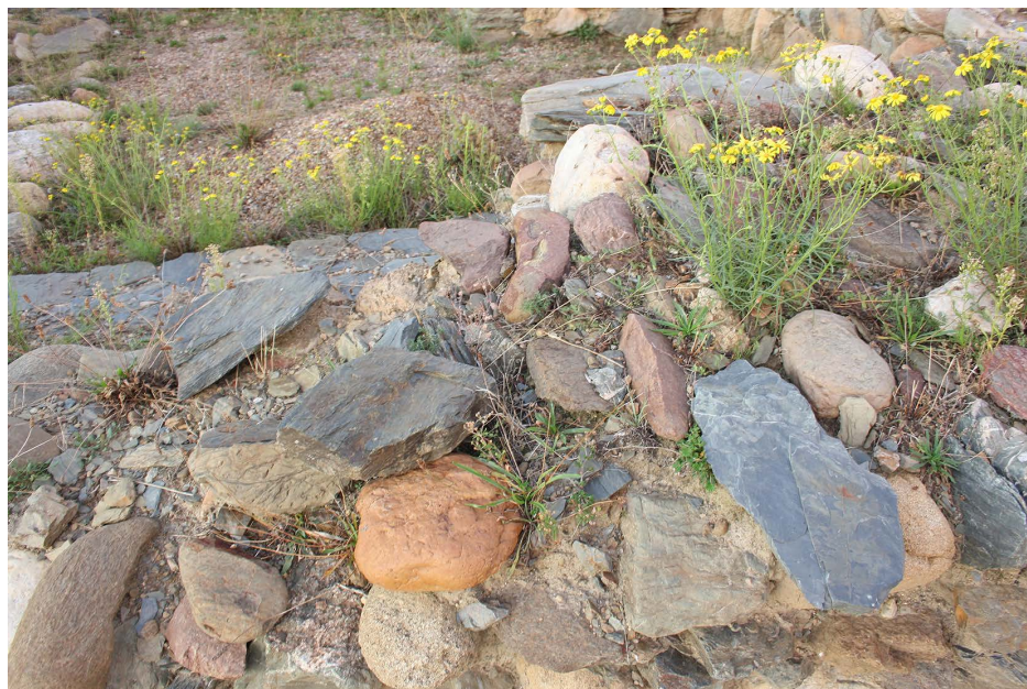
Figura 7. Alteracions del mur medieval UE 342 d'El Castellot causades pels agents biològics, provocant moviments i pèrdua d'elements estructurals.
