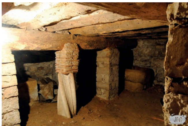
Fig. 4. Columna torxada reaprofitada com a pilar al celler del nivell de la planta semisoterrada (Foto: Jordi Ibars)
