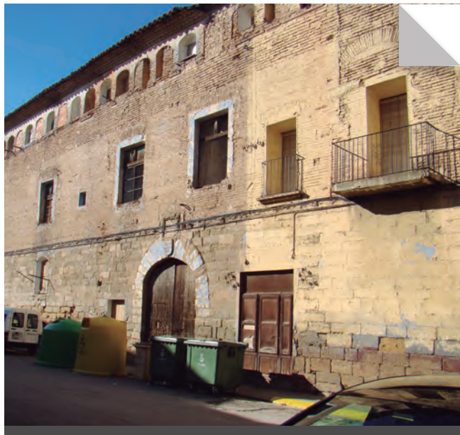
Fig. 2 - Imatge de la façana meridional del palau on s'obre la porta principal que permet apreciar la tècnica constructiva de l'aparell constructiu del seu parament exterior. (Fotografia M. Monjo-I. Pastor)
