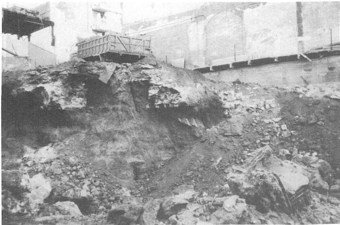
Detall del mur perpendicular, al carrer d'En Palau, núm. 20 (en curs de destrucció).
