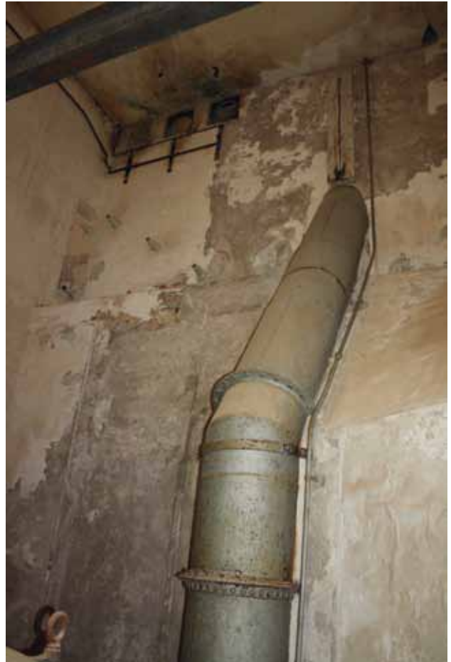
Paret de la sala de màquines: al centre, la canonada forçada; a dalt a l'esquerra es veuen els passamurs per al cable, forats de sortida dels cables elèctrics; just a sota hi ha la base del seccionador de la línia i alguns aïlladors de porcellana; just a sobre, al sostre, es veuen marques de cremades ocasionades pels arcs voltaics en el seccionador; la biga metàl·lica superior servia per hissar les màquines; a sobre de la canonada hi ha el regle que indica el nivell d'aigua de la bassa; a baix queda el pern per hissar la turbina.
