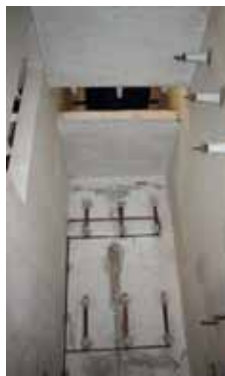
Compartiment de seccionadors. Bases de seccionadors i aïlladors de porcellana.
