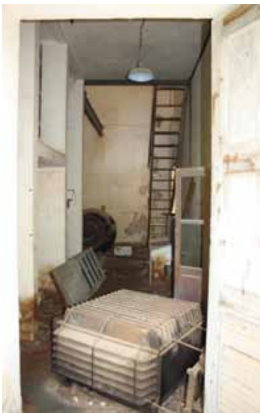
Sala de màquines vista des de l'entrada de l'edifici. Transformador d'oli tombat i buit en primer pla; a l'esquerra, compartiments per al transformador, l'interruptor i els seccionadors. Al fons hi ha la turbina, la biga d'hissar i les escales d'accés a la segona planta (en mal estat). Sota l'escala es troba la taula de control i mesura.
