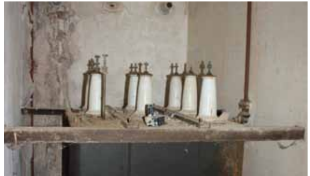
Interruptor en bany d'oli. Els aïlladors de porcellana de la part superior rebien els cables elèctrics. L'interruptor queda a l'interior de la caixa.
