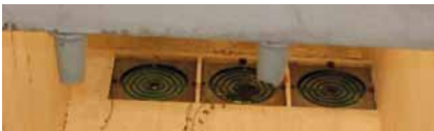
Sortida dels cables cap a la distribució. En primer pla, aïlladors trencats de porcellana blanca, i en segon pla, passamurs circulars de vidre encastats a la paret. El cable anava d'aïllador a aïllador fins al centre del passamurs, i d'allí a les torres de distribució.
