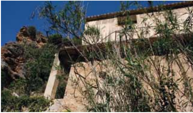
Façana de l'edifici vista des de la llera del riu. El túnel i les escales d'accés queden a l'esquerra. Darrera el canyissar hi ha la sortida d'aigua al riu.
