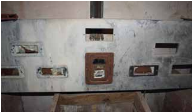
Frontal de la taula de control i mesura, realitzat amb marbre, que conté el comptador al centre i diversos instruments de mesura als laterals.
