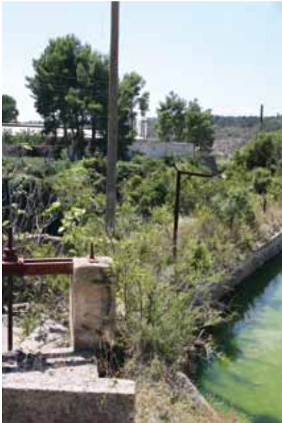
Sortida de la bassa cap a la canonada forçada d'alimentació de la turbina, amb comporta i suport de la boia de nivell.
