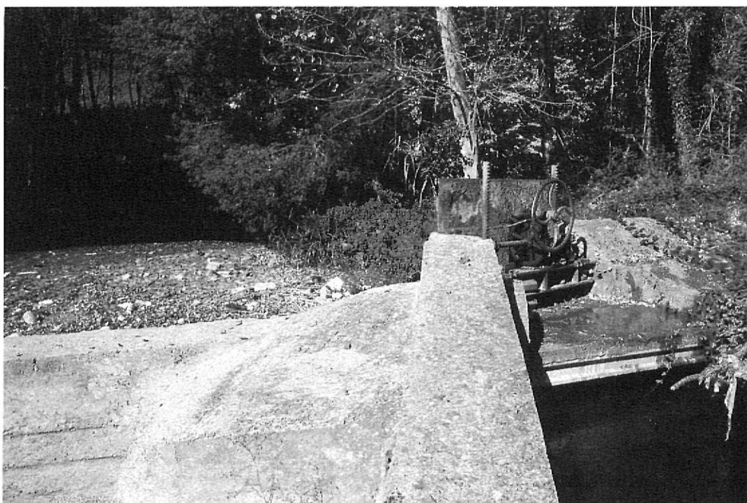
Represa al riu Terri, on s'aprecia totes les deixalles que s'hi acumulen.
