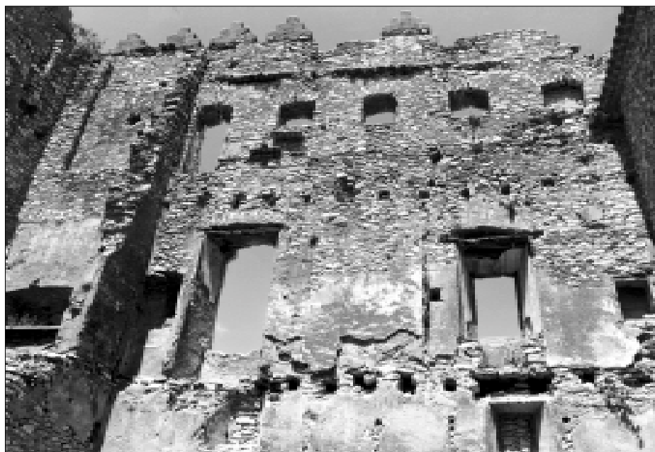
□ Vista interior de la façana nord. Els forats dels embigats assenyalen l'alçada dels pisos
