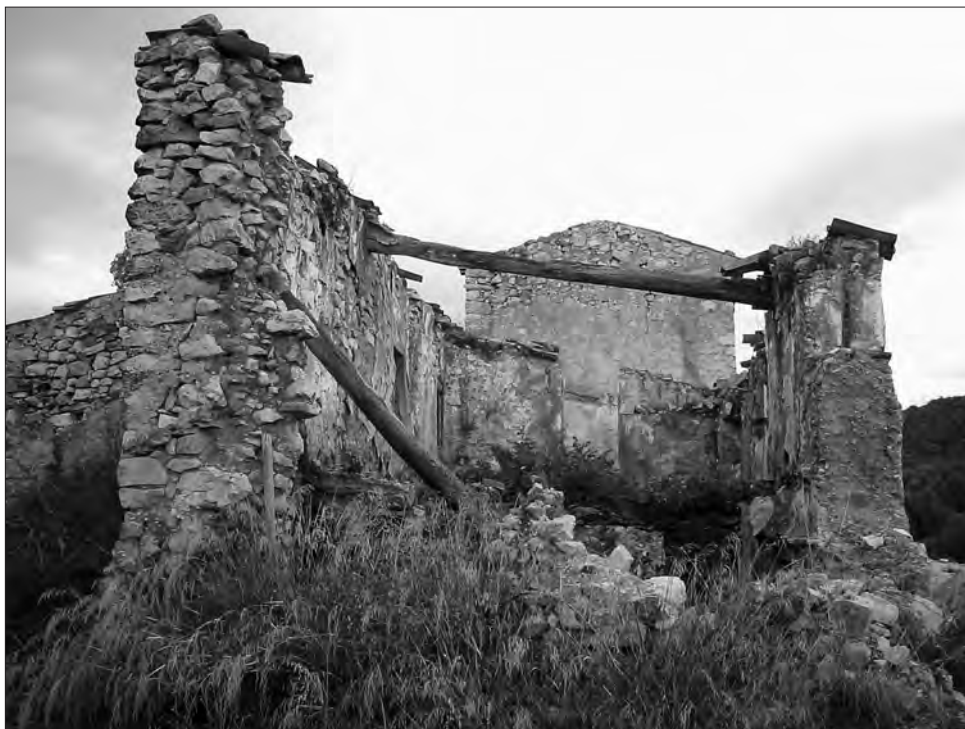
□ Figura 11: El Cos 4 vist des de la façana oest. Com es pot comprovar, l'edifici es troba a un pas del complet enderroc.
