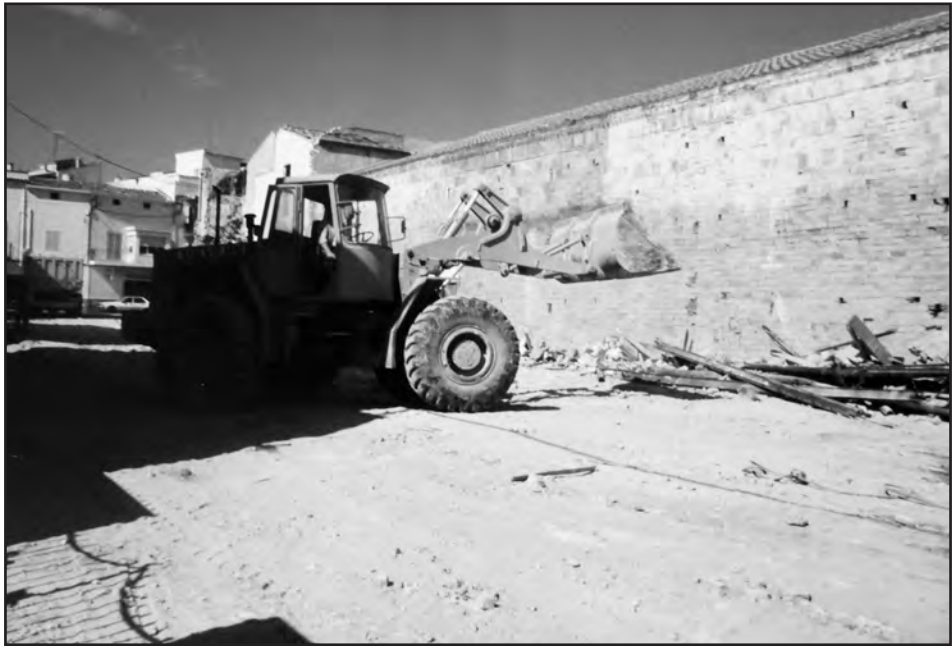
27. Una altra imatge del mateix enderrocament. A la dreta es pot veure el mur de maons del magatzem que va construir CEMSA al pati de la fàbrica vella. 50
