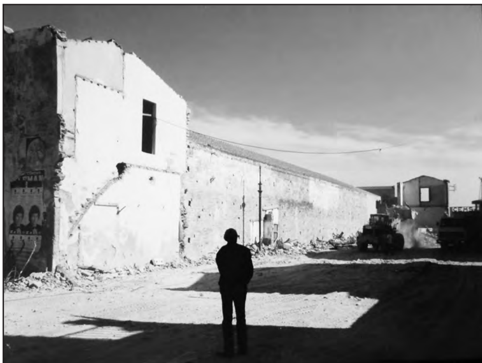
26. Fotografia de l'enderrocament de la nau llarga de la vella fàbrica. A l'esquerra es pot veure les restes de l'escala per la qual s'accedia als habitatges del pis superior del damunt de la nau. 1986. 49
