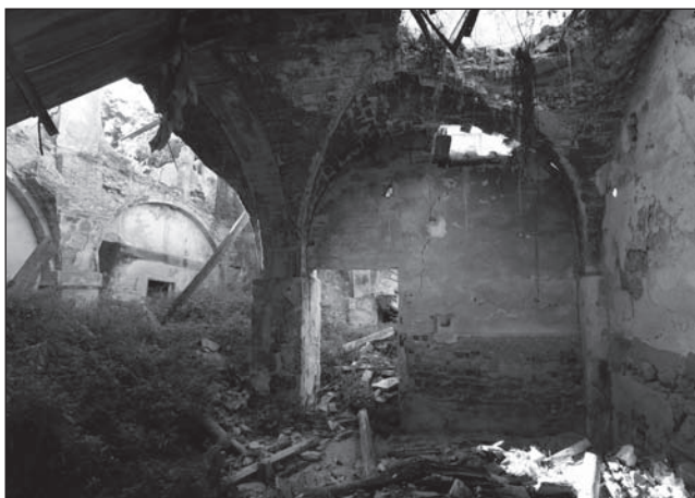
Lámina 10. Ruinas del edificio (de 2x2 crujiás) que se adosó al molino original abovedado en la planta baja (estado en 2012). Foto Museu Arqueològic d'Alcoi.
