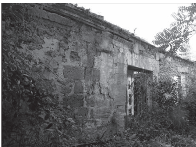
Lámina 11. Fachada posterior y acceso a las plantas superiores de la nave ampliada. Se observa la zona de contacto de ambos muros, y los refuerzos metálicos que se incorporaron posteriormente para contrarrestar los desplazamientos (estado en 2012). Foto Museu Arqueològic d'Alcoi.
