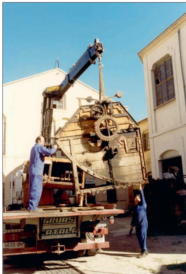
Làmina VI. Trasllat de màquines recuperades a la fàbrica Hijos de Fco. Matarredona, donació de Textil Beniata Cooperativa Valenciana Limitada.
