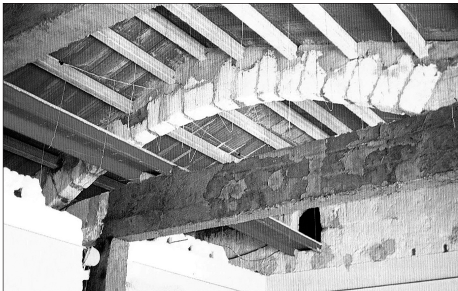
Volta de marès apuntalada
