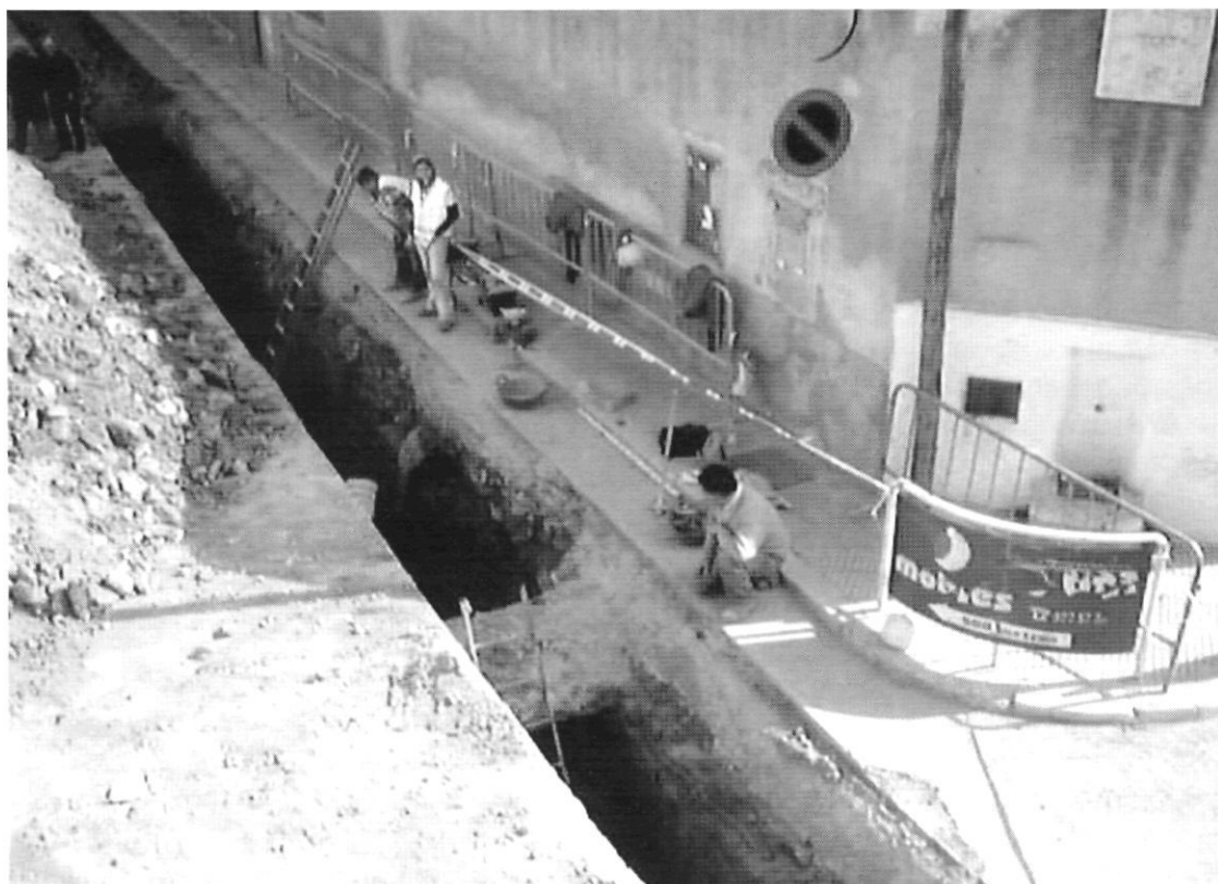
Imatge 14. Vista general de les obres a la zona on van aparèixer els arcs del Portal de València. Font: Escola Taller "L'antic Hospital".
