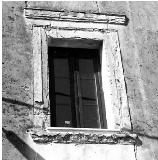
Detall d'una de les finestres de la primera planta (Font: fotografia cedida per Maria Rita Yvars)
