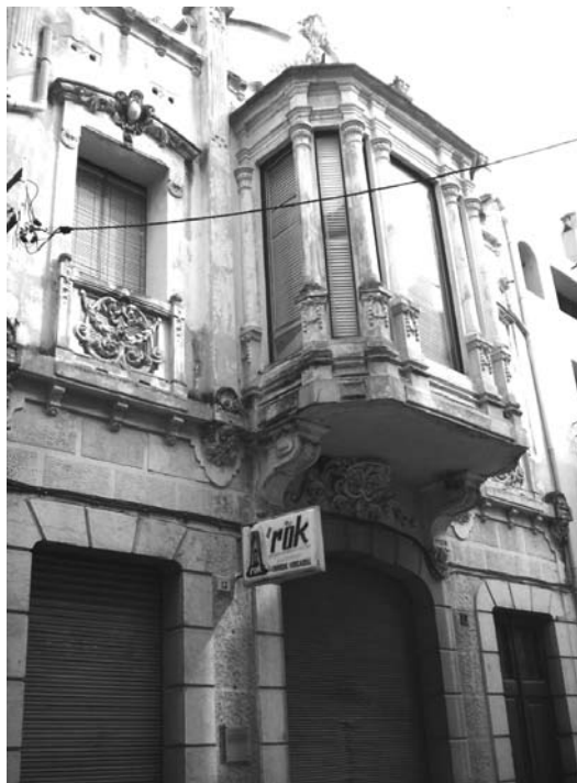
Casa del Gato, suposadament de l'arquitecte Cèsar Martinell, situada al carrer de Sant Antoni, núm. 13. es pot observar el precari estat en què es troba actualment. (FONT: Elaboració pròpia )
