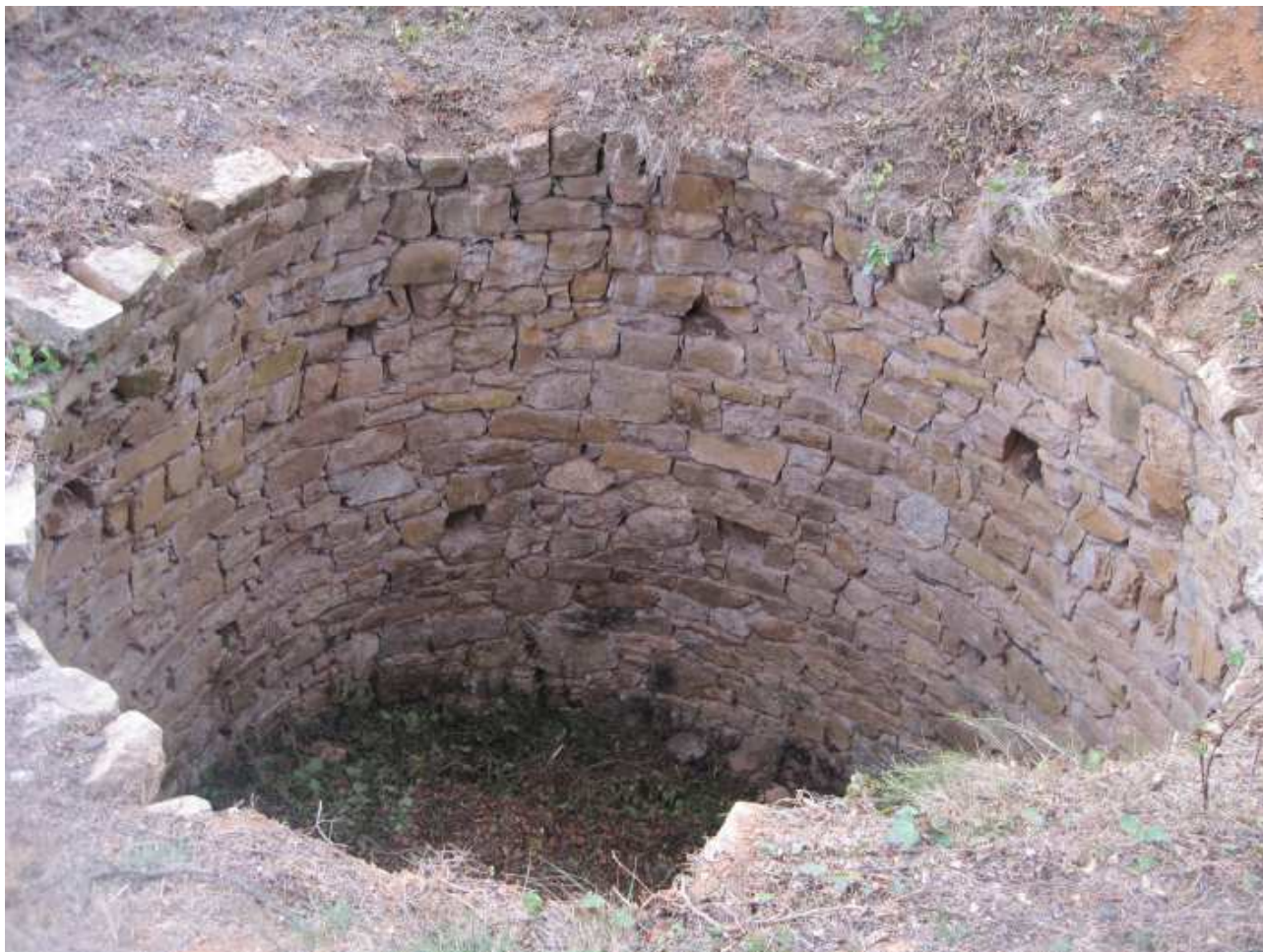
Foto 4. A la imatge podem veure la part superior del pou abans d'iniciar els treballs d'extracció del sediment de l'interior. S'observen els forats que hem parlat abans que foren emprats pel bastiment de les parets del pou. L'obertura superior, abans d'iniciar els treballs feia 5 metres de diàmetre.
