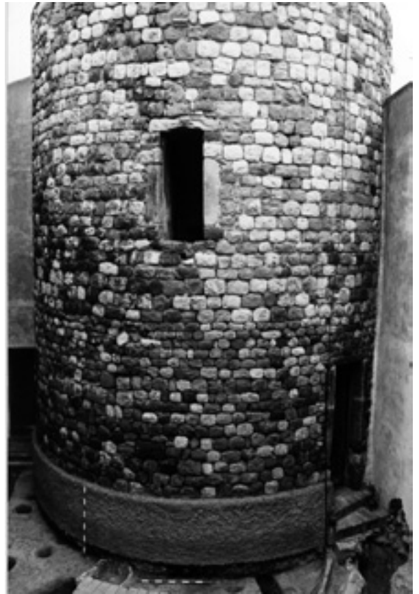
Fig. 1. Vista de la part inferior de la torre (s. XII) situada al centre de l'edifici. S'observa la finestra oberta en el primer pis, la porta d'accés actual i la seva fonamentació descalçada i tapada per una capa de ciment.
