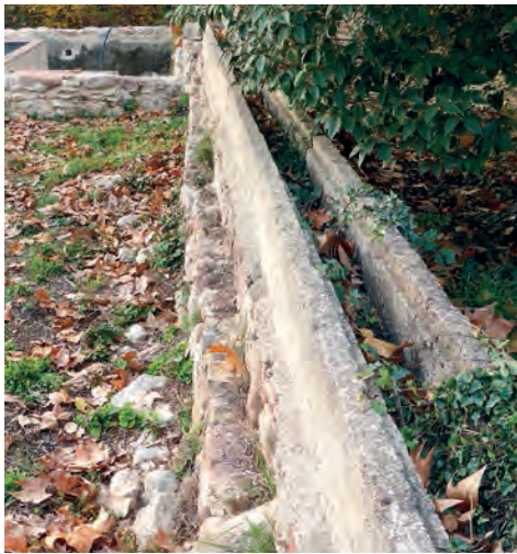
Figura 2. Aspecte actual (desembre de 2015) de la mina de Can Cruz a l'alçada de la bassa de Can Jornet Xic. Foto: J. Bertran
