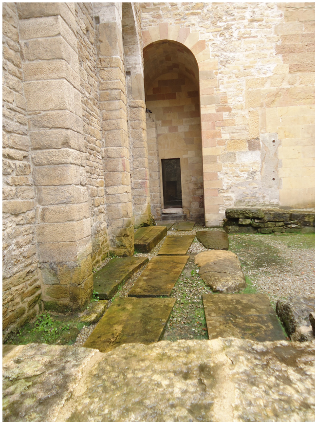
Fig. 2: Estado actual del pórtico norte de la Cámara Santa, incluyendo la reproducción de la lauda del obispo Froilán colocada en el lugar de enterramiento original.
