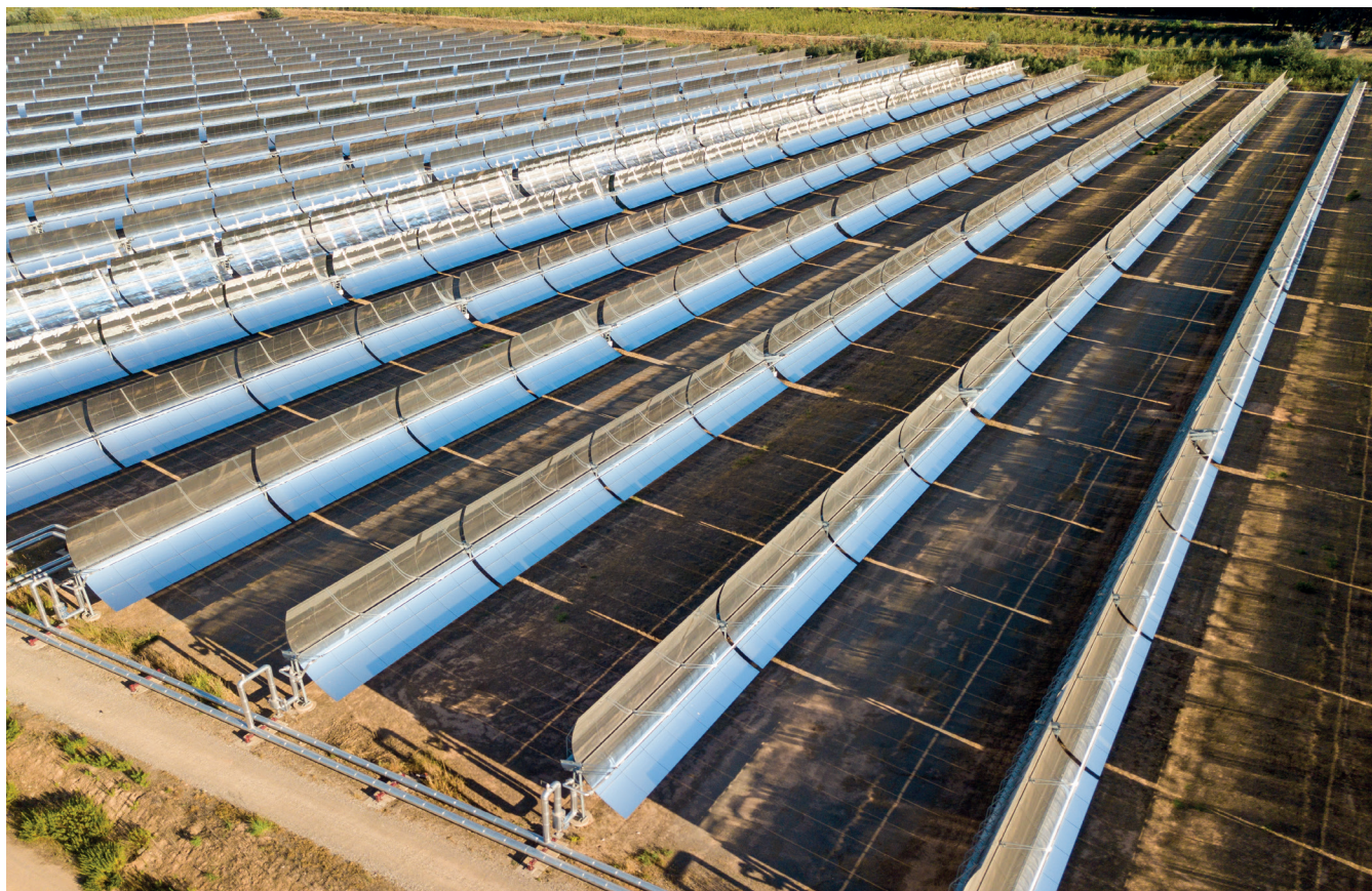
► Miralls cilíndrico-cònics de central termosolar.
