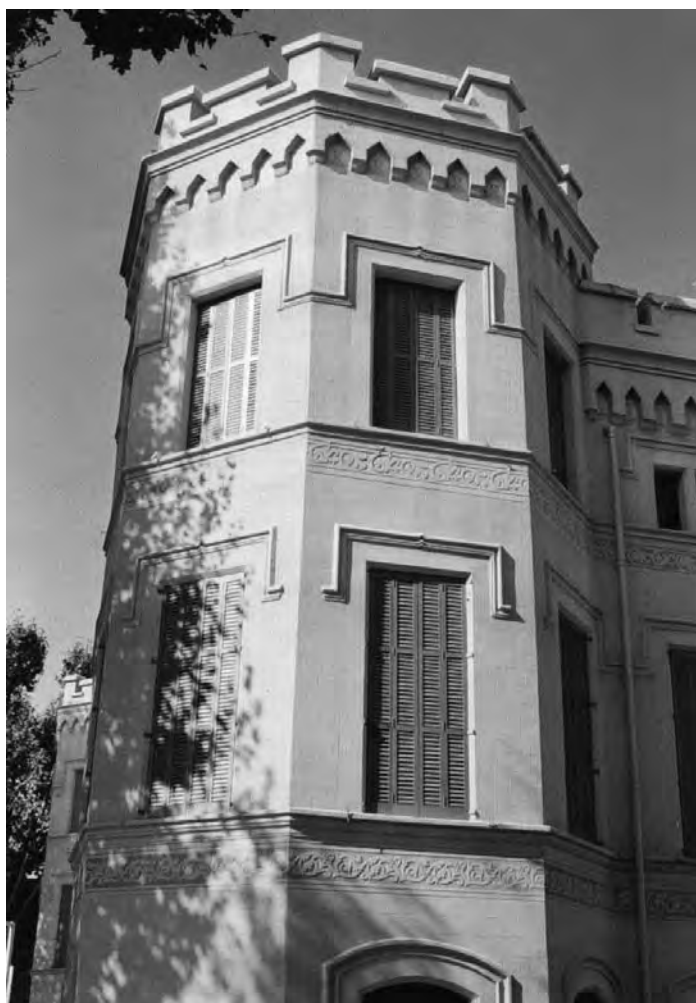
Can Mercader, Cornellà. Estuc amb ciment i voladura de frisos.
