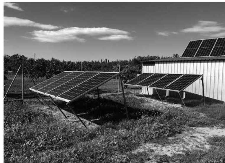
Instal·lació solar fotovoltaica per al bombeig d'aigua en sistemes de regadiu a pressió. Foto: Josep Papió Toda.
