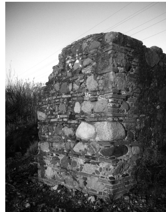
Estacada a la riera de Maspujols, en defensa de les terres del mas del Toda, construïda a finals del segle XIX, amb rajoles de rebuig de la Bòbila i pedres. Foto: Ian.
