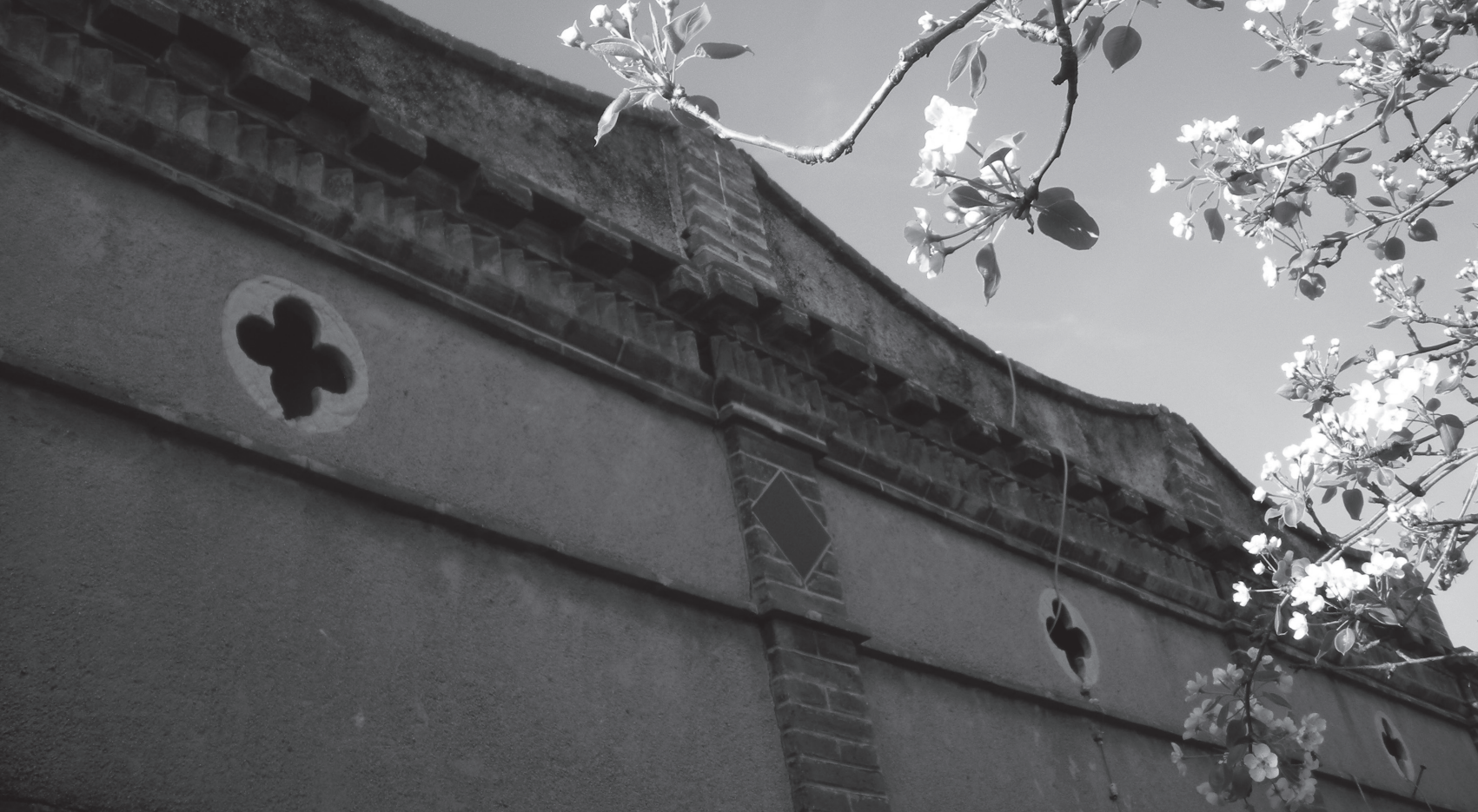
Façana del mas dels Albellons, a la Clota, amb rajoles pintades, un rematat a la façana que simula onades de mar i un quèrn de ventilació en forma de flors de quatre pètals. Construït en el tombant dels segles XIX-XX. Foto: Ian.
