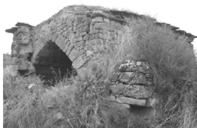
Cantonada nord-est de la cabana, amb la façana enderrocada, mirant a l'est
