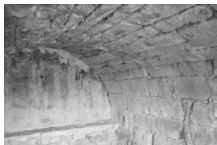
Interior de la cabana amb el detall de la menjadora en el mur posterior
