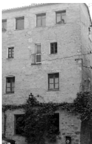
Vista frontal i lateral de la casa de les Monges abans de la darrera restauració
