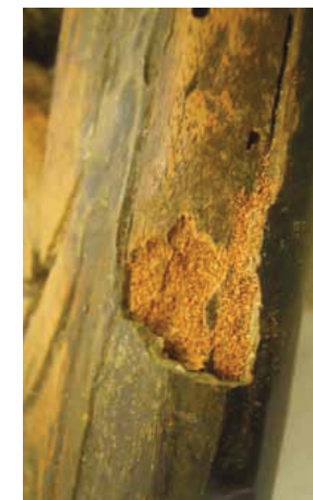
Degradació sota massilla.
