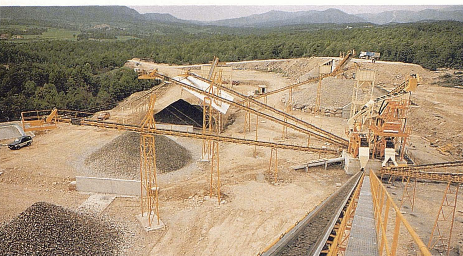
Fotografia 7: Vista general de la planta de tractament d'àrids. És situada al marge dret del riu a uns 10Km aigua avall de la tancada.
