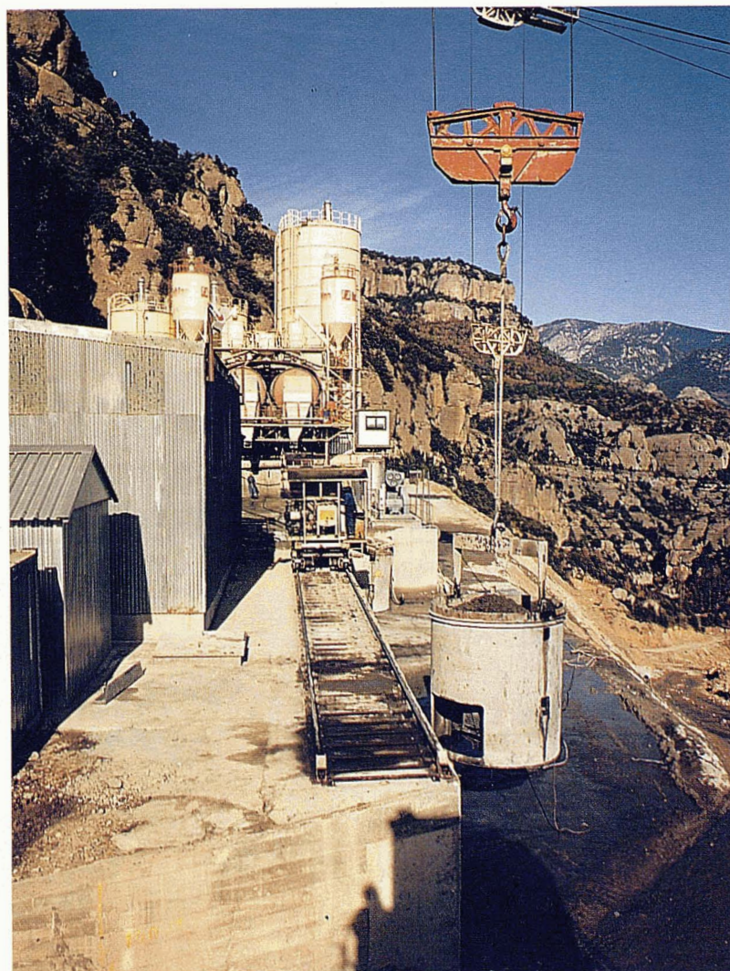
Fotografia 12: El formigó recent fabricat es transporta fins al cubilot que el col·locarà en obra.
