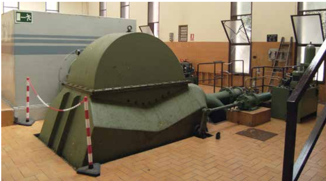
A primer terme la turbina Neyrpic de 2.900 CV i al darrera el generador (GENTILESA DE RAMON SOLER)
