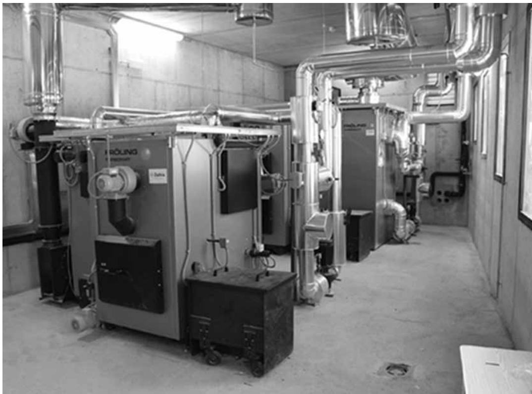
Caldera de Biomassa.
