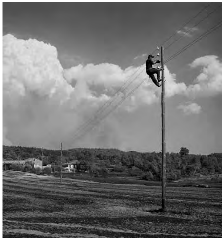
Reparació de la línia de Gargallà en què s'originà el foc. MANEL ESCOBET
