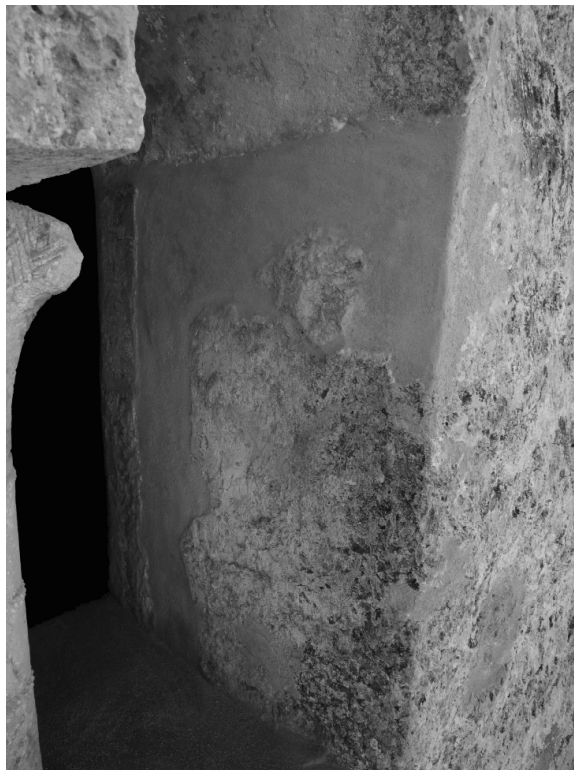
Figura 6. Finestra geminada. Arrebossat del costat sud original de l'església del segle XI. Superior: durant el procés de restauració (IA.07.1463). Inferior: després de la restauració (IA.07.1823).
