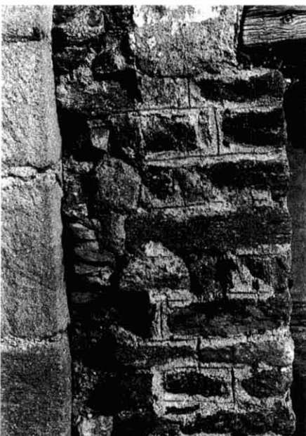
Figura 15. - Reminiscència de tècniques de construcció antigües. Fals aparell fet amb junts d'incisió a Sant Miquel de Cuixà en els temps de l'abat Oliba.
