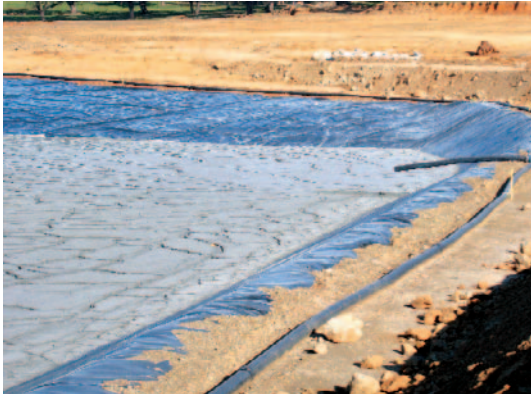
Fig. 13. Geomembrana para evitar filtraciones de los lodos.
