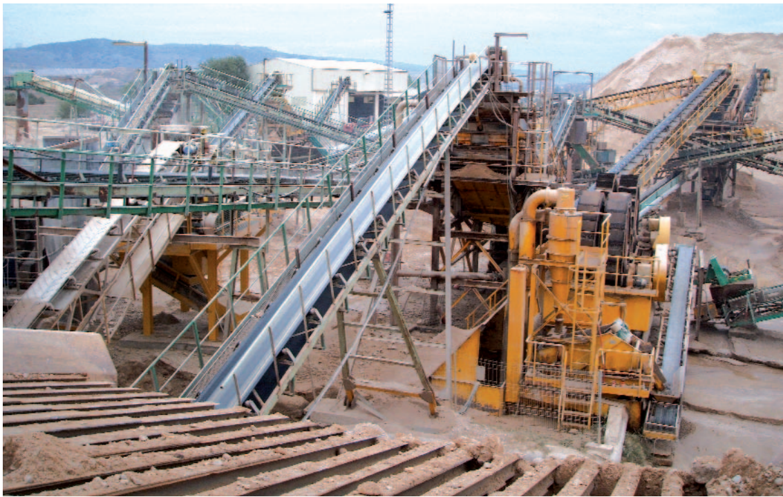
Fig. 3. Planta de tratamiento para el lavado y clasificación de los áridos granulares.
