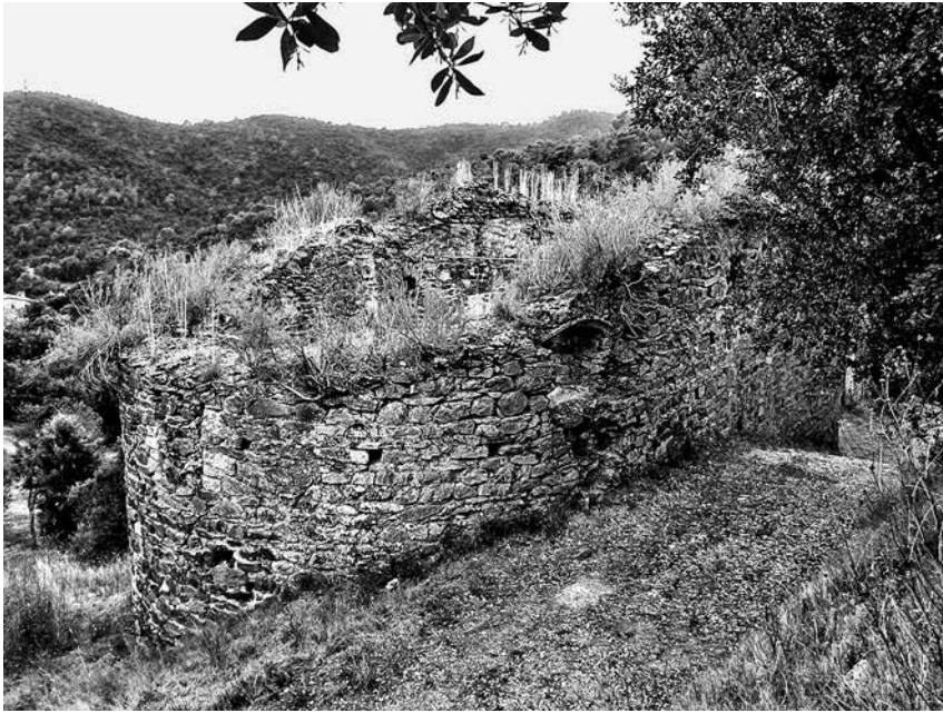
Fig. 3. Vista de la zona de l'absis de l'església abans d'iniciar-se'n la restauració. El conjunt se'ns mostra enrunat, sense coberta, i amb importants esquerdes que feien témer per la seva estabilitat.
