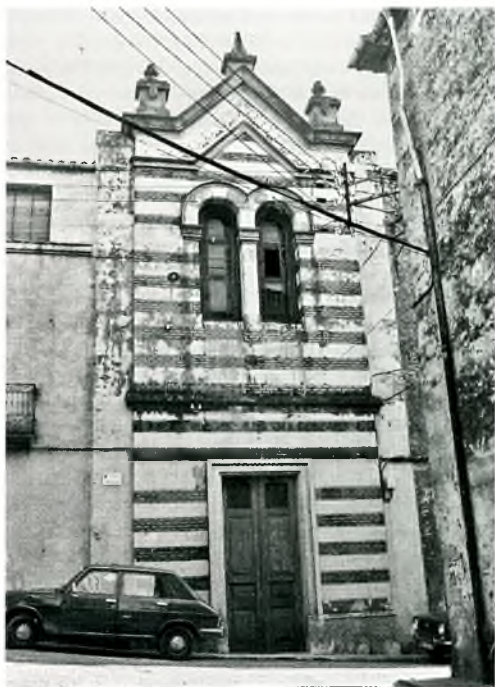
19- Estat actual de la façana de l'església del Carme que necessita una urgent restauració (Arxiu COLONICO)
