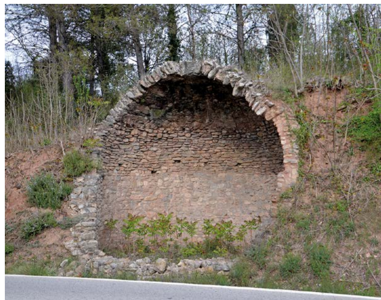
Pou de glaç d'Horta, a peu de carretera. S'observa l'ús majoritari de còdols en la seva construcció
