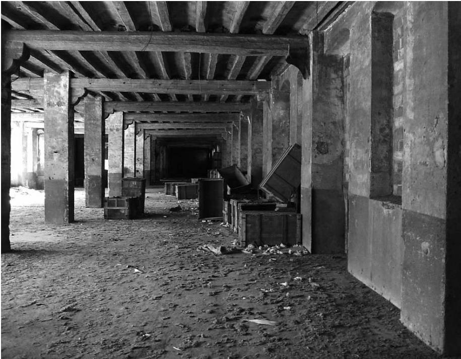
Interior de la primera planta de la fàbrica dels Panyos el 2006, abans de la rehabilitació de la coberta. S'hi pot veure l'estructura del sostre, amb bigues i revoltons, i les caixes abandonades en el tancament de la darrera empresa (foto: Lucía Juárez / Lluís Virós)
