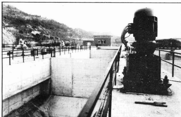
Vista parcial de la depuradora. Basses d'aireació.
