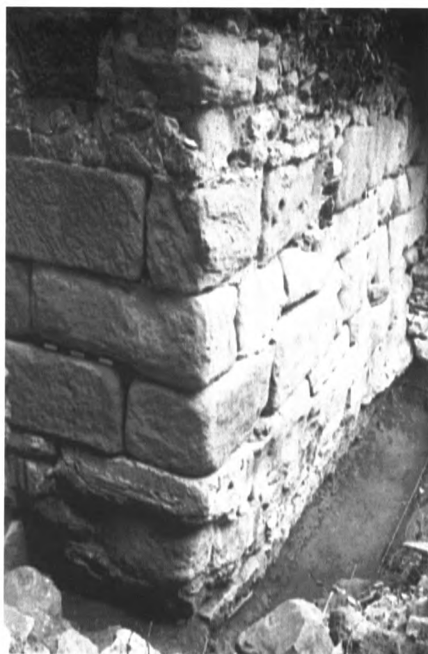
Fig. 9.- Caserna d'Alemanys. Vista general de la part romana de la torre del Telègraf.
