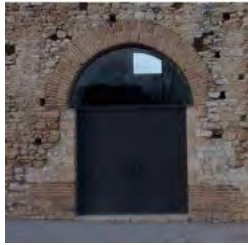
Figura 20. Façana sud. Exterior de la porta d'entrada a la sala de la cúpula (Foto: Ricard Ballo, 2015).
