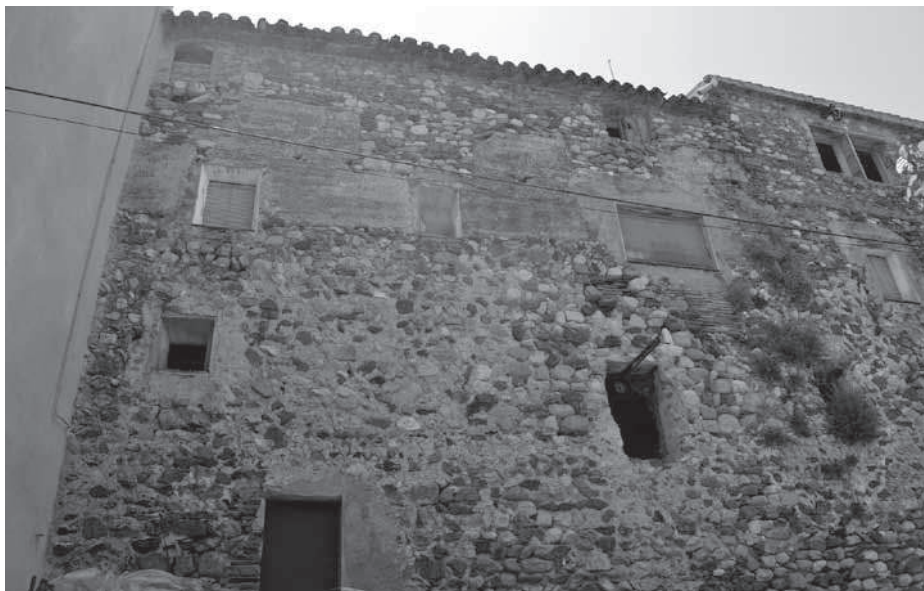
Un dels trams de muralla actualment més fàcilment restaurables. Raval Sant Pere (Foto Maties Solé).
