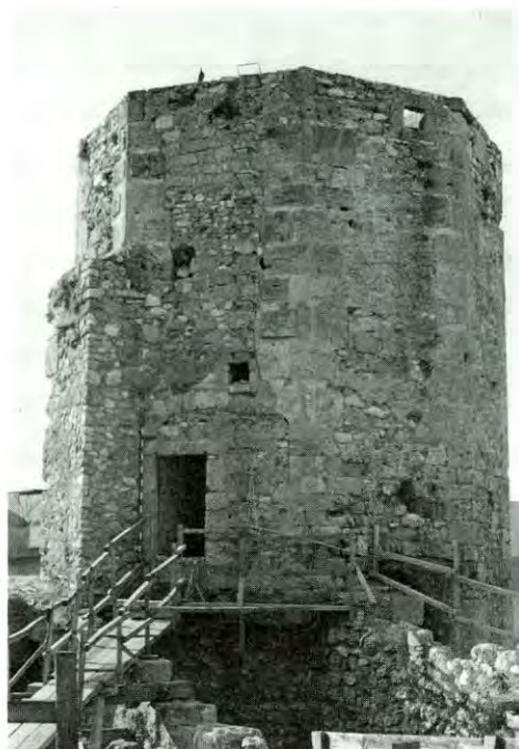
Figura 15. Detall de l'extrem superior de la torre des de la capçalera oriental del Circ (aprecia la porta actual d'accés a l'estança interior de la torre).
