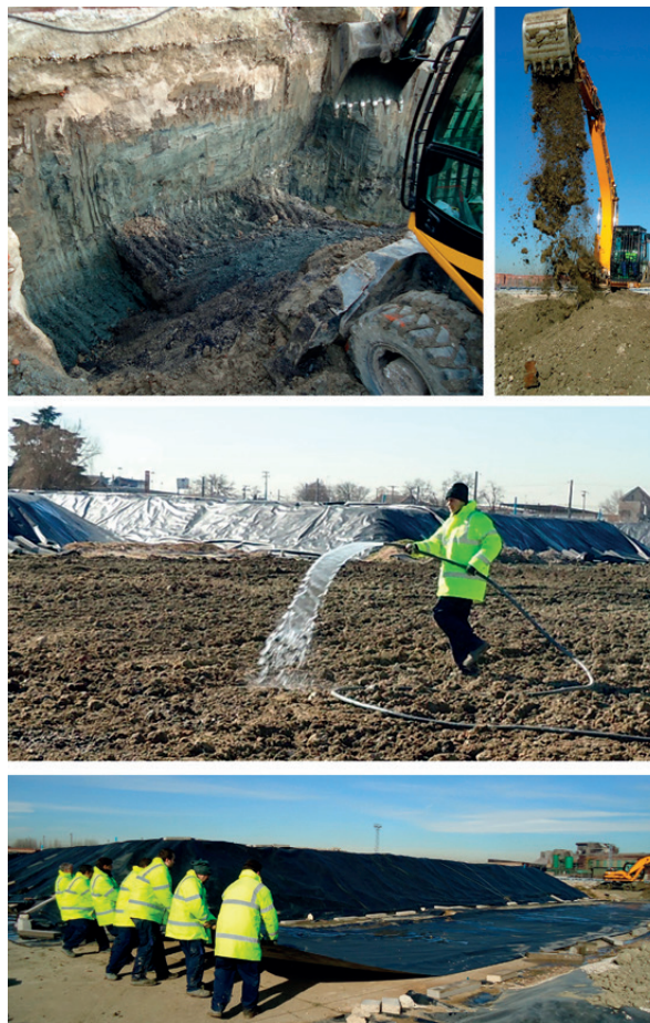
Figura 9. Construcció de biopiles aeròbics pel tractament d'un sòl contaminat per gasoil i olis minerals en un emplaçament de la Comunitat de Madrid. La descontaminació la va dur a terme l'empresa Geotecnia 2000 (Grupo TÜV_SÜD ATISAE). En les imatges es poden veure els processos d'excavació, homogeneïtzació, reg i construcció de les piles de sòl cobertes amb una lona impermeable. Les fotografies han estat cedides per l'empresa.
