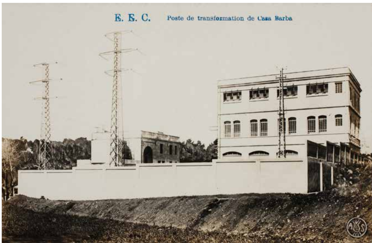
Figura 2. Instal·lacions elèctriques a la masia de Can Barba. Sabadell, dècada de 1920. Edició postal. Fotografia: autor desconegut (AHS).
