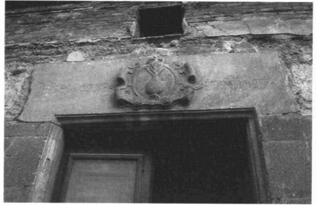
Fotografia 5. Detall de la llinda del balcó del carrer de Gràcia. S'observa la reparació amb maons i morter de l'obertura del mur per encabir-hi la llinda. Autora: Gemma Caballé.
