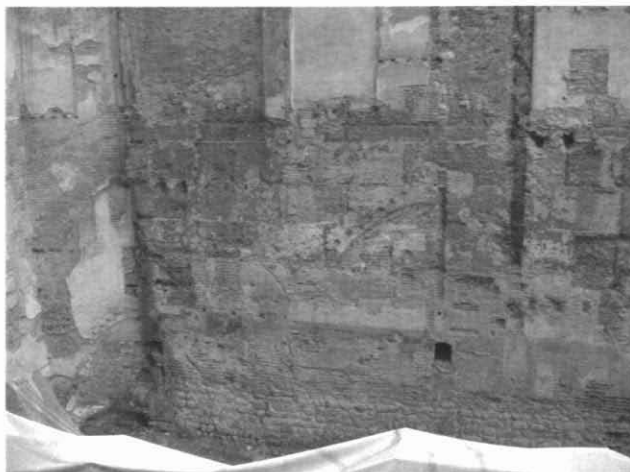
Fotografia 3. Mur de tancament est del casal. Vista general un cop repicat. S'aprecia la base i el mur de tàpia de la muralla baixmedieval; al damunt, el mur de tàpia del Casal de l'Estudi; per sobre d'aquest, s'aprecia la part del mur superior, aixecada el 1867, fet amb pedres i maons. Autor: José Antonio Cantos.
