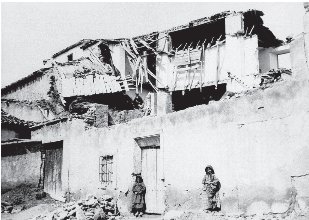
Figura 6. Daños en Jayena. Este pueblo fue inicialmente considerado (equivocadamente) con pocos daños.
