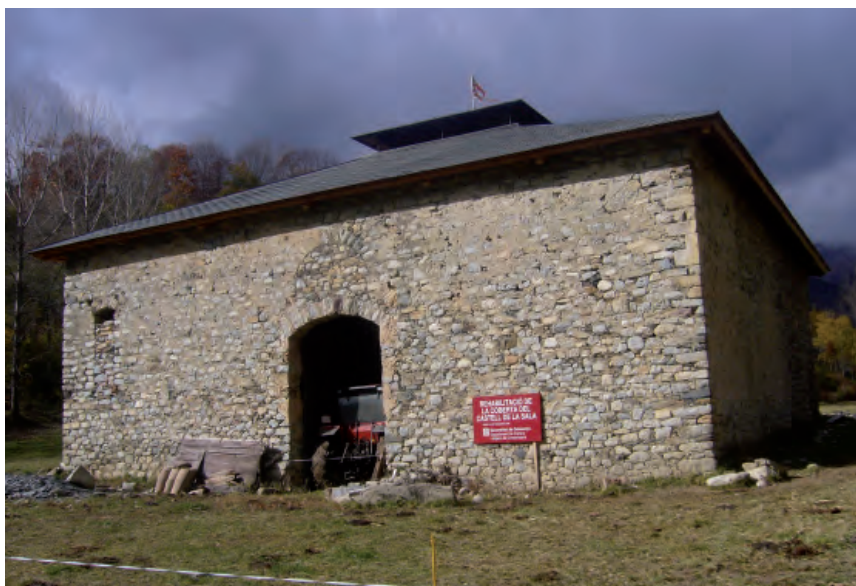
Vilallonga. Castell de la Sala. Canvi inadequat de materials i perfils a la teulada (S. Llagostera)
